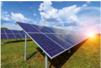
Centrale au sol
