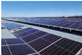
Centrale en toiture
