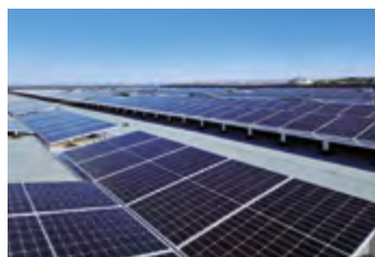
Centrale en toiture
